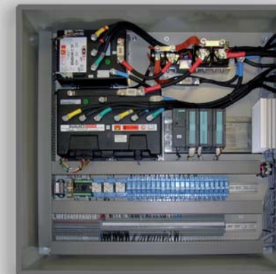
ATECH Schaltschrank mit Lenkrechner und allen Leistungsteilen, Schützen, Sicherungen und Klemmleisten
